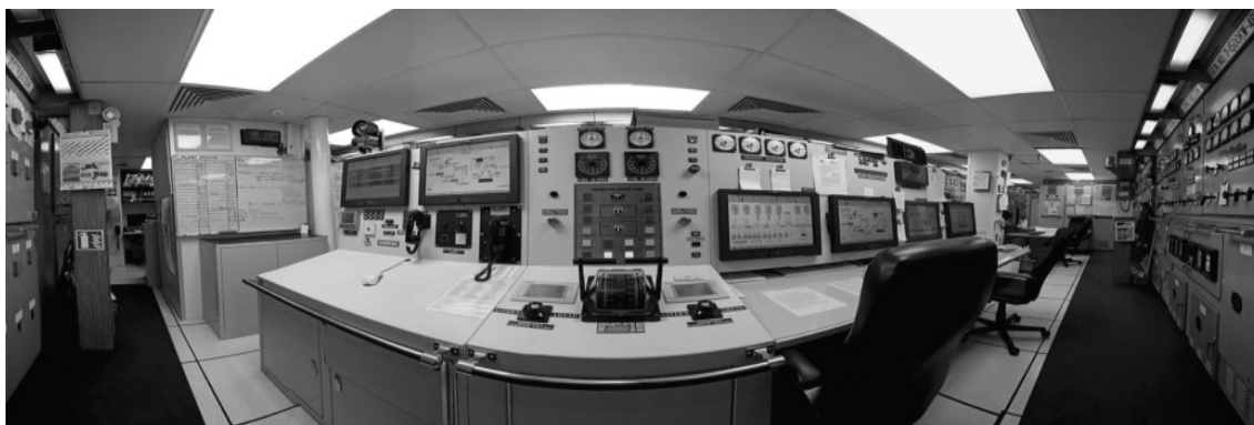
Рис. 1. Фото центрального поста управления танкера
